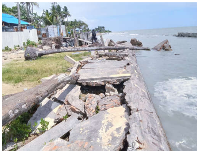
Dampak Kerusakan yang ditimbulkan akibat penggenangan dan abrasi.
