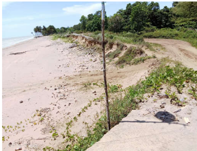
Kerusakan pada akses utama penghubung Nassai dengan Kumbe akibat talung yang sudah hancur
