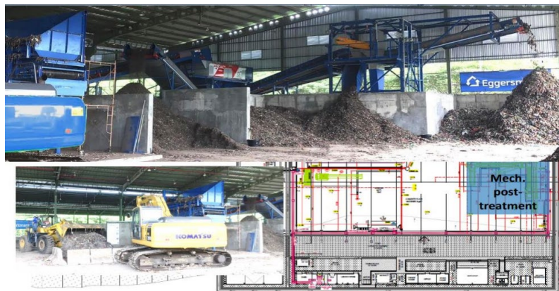
Gambar 3.8 Mesin screen di fasilitas RDF Plant Cilacap
