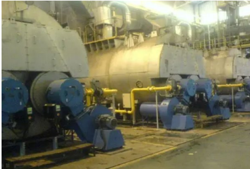
Gambar 6.10 Boiler di CRM PT KS
